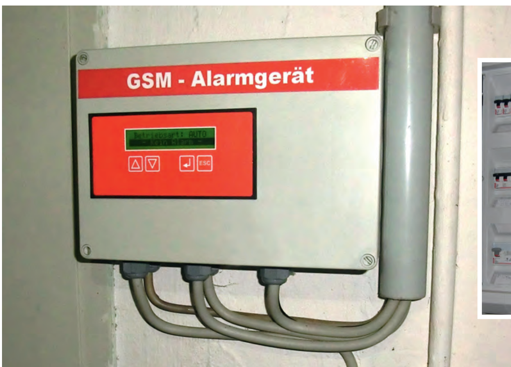
Bild 6 | Alarmgerät mit eingebauter telefonischer Weiterleitung über das Handynetz, Quelle:alcona Automation
